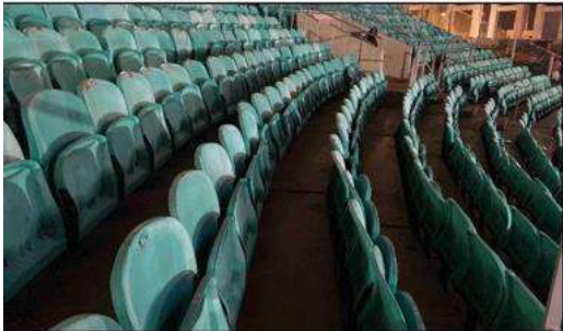
Figura 65: N5 Bloco 105 Eixo 11
