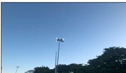
Figura 262: Inconformidade - Poste com luz apagada Estacionamento EE
