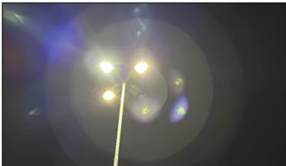
Figura 184: Inconformidade - Poste com luz apagada Estacionamento EE
