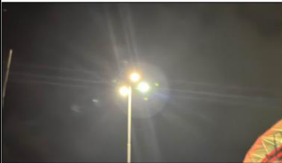
Figura 177: Inconformidade - Poste com luz apagada Estacionamento EE
