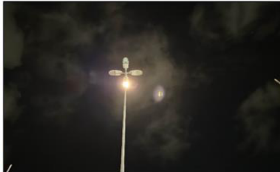
Figura 174: Inconformidade - Poste com luz apagada Estacionamento EE
