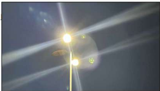
Figura 224: Inconformidade - Poste com luz apagada estacionamento EE
