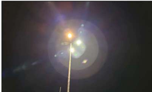
Figura 215: Inconformidade - Poste com luz apagada Estacionamento EE
