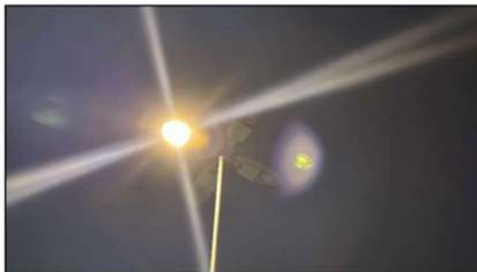
Figura 225: Inconformidade - Poste com luz apagada Estacionamento EE
