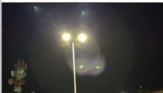
Figura 218: Inconformidade - Poste com luz apagada Estacionamento EE
