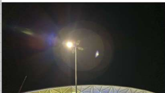
Figura 222: Inconformidade - Poste com luz apagada Estacionamento EE
