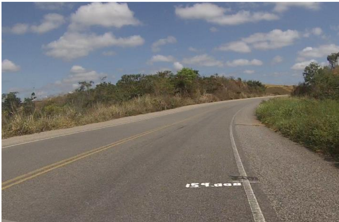
Figura 14 - km 158+000 ao km 163+500 (km 159+000): Sinalização horizontal visível com poucas placas localizada no bordo.
