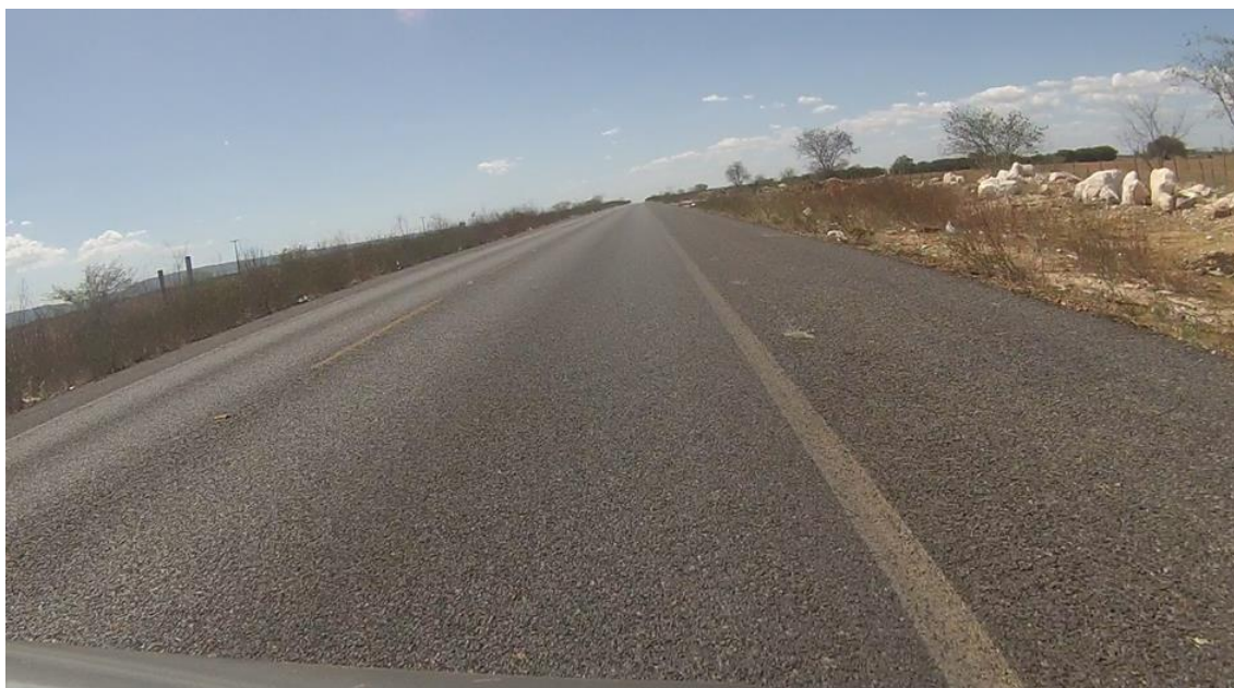
Figura 38 - km 419+000 ao 436+300 (km 419+000): Trecho rural, sinalização ruim e desgastada.
