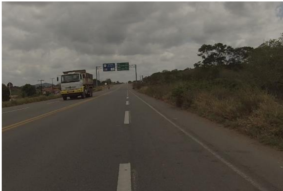
Figura 1 - km 0+000 ao km 0+500 (km 0+500): Trecho urbano, sinalização desgastada e/ou inexistente.
