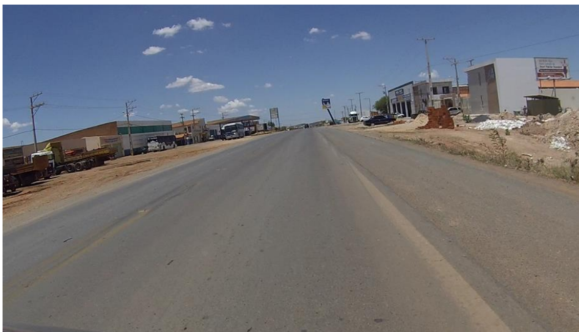
Figura 33 - km 352+200 ao km 354+000: Trecho urbano, sinalização desgastada.
