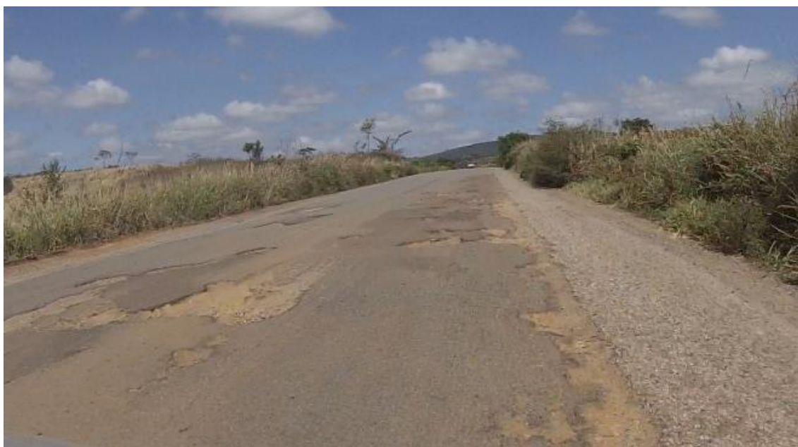
Figura 17 - km 173+000 ao km 174+900 (km 173+300): Sinalização horizontal deteriorada (faixas descascando com muitas "panelas" no bordo da pista e na faixa amarela); sinalização vertical praticamente inexistente.
