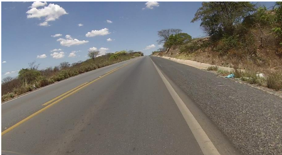
Figura 34 - km 354+000 ao km 360+000 (km 357+200): Sinalização boa, porém suja e desgastada.
