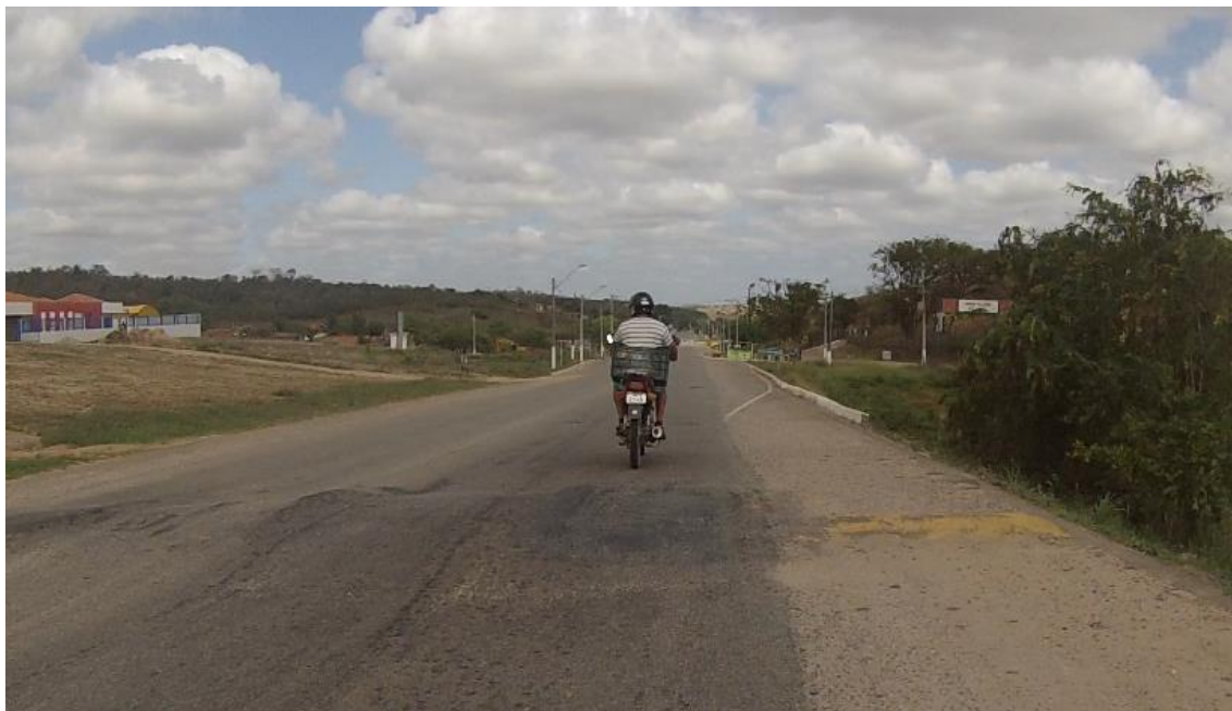
Figura 12 - km 104+000 ao km 139+600 (km 138+300): Trecho urbano, sinalização desgastada e/ou inexistente.
