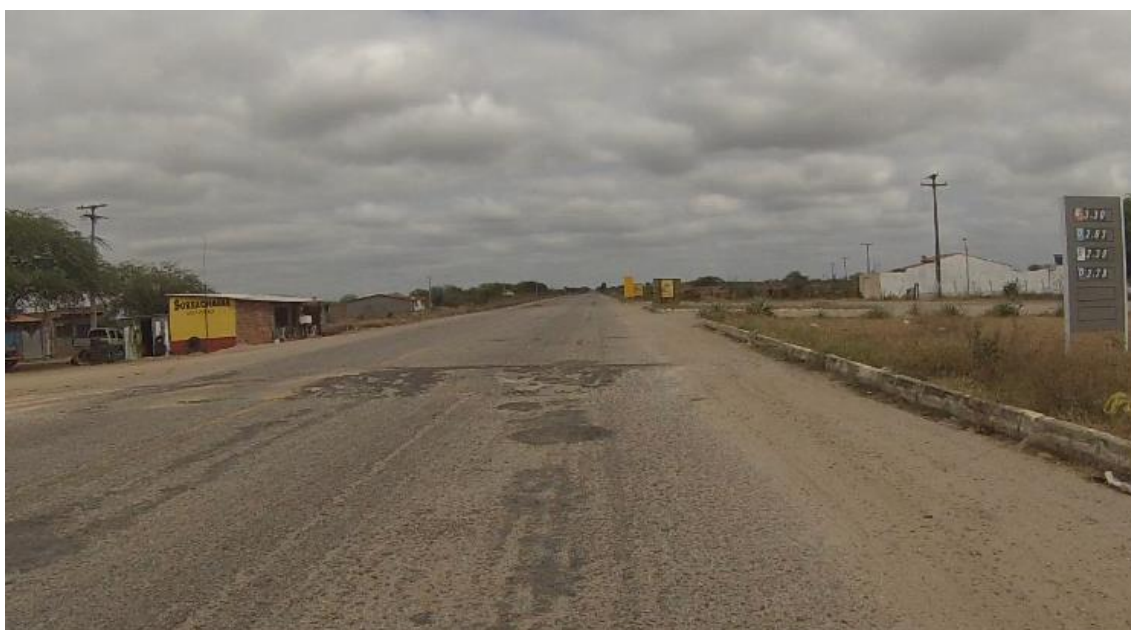
Figura 11 - km 86+200 ao km 104+000 (km 103+800): Trecho urbano, sinalização desgastada e/ou inexistente.
