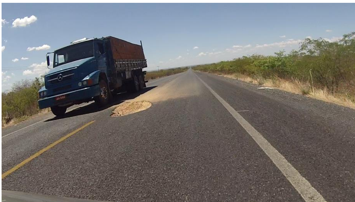
Figura 37 - km 387+000 ao km 418+500 (km 396+400): Trecho rural, sinalização boa, porém, suja, desgastada e com buraco na via.
