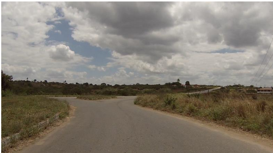
Figura 3 - km 12+000 ao km 13+000 (km 13+000): Rotatória, sinalização desgastada e/ou inexistente e falta à pintura de bordo.
