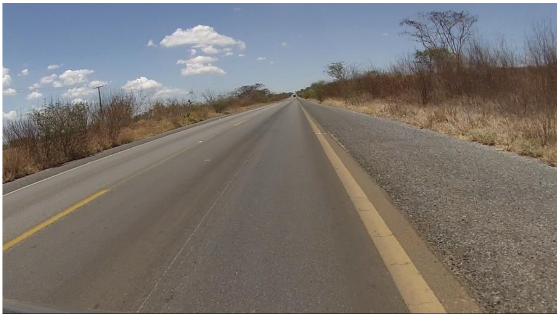
Figura 36 - km 377+000 ao km 383+000 (km 377+200): Trecho rural, sinalização boa, porém, suja e desgastada.
