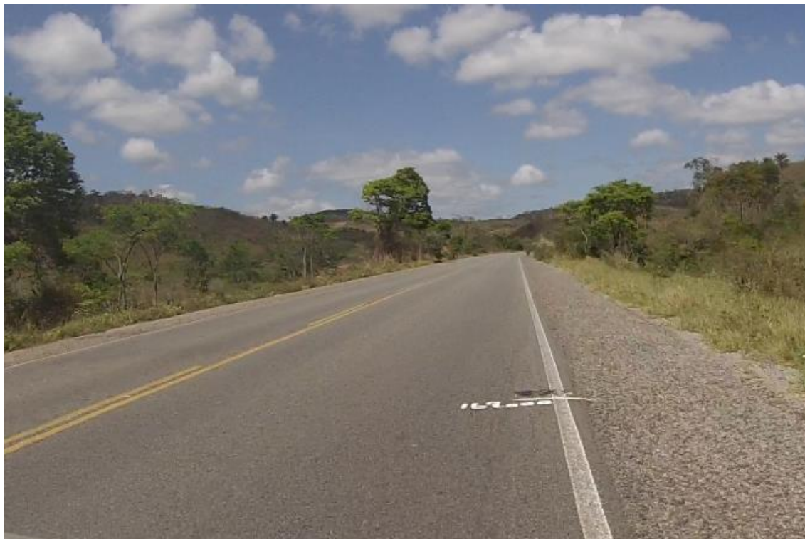
Figura 16 - km 168+000 ao km 173+000 (km 169+000): Sinalização horizontal visível com poucas panelas localizada no bordo.
