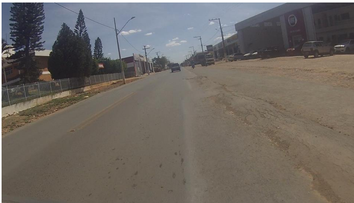
Figura 43 – km 0+000 ao 4+900: Trecho urbano, sinalização horizontal deteriorada e buracos na via.
