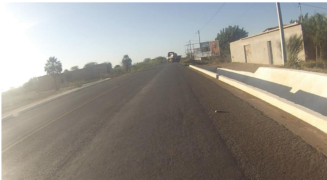
Figura 40 - km 0+000 ao 37+500 (km 0+100): Trecho urbano sinalização horizontal ruim e desgastada.
