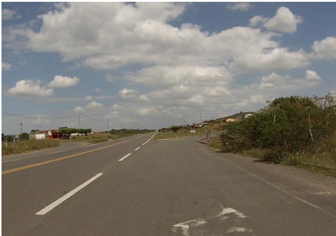
Figura 7 – km 28+500 ao 41+400 (km 41+300): Rotatória, sinalização desgastada e/ou inexistente.
