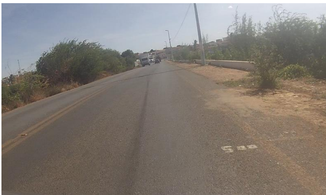
Figura 46 - km 41+100 ao 42+200 (km 41+500): Trecho urbano, sinalização horizontal desgastada, falta defesa metálica em ambos os lados (talude negativo) .
