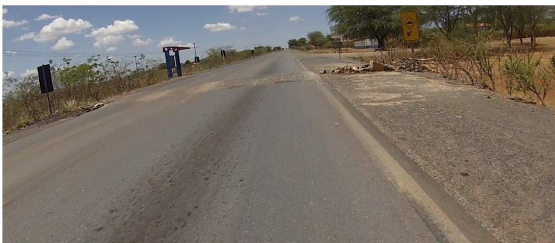
Figura 35 - km 370+000 ao km 377+000 (km 373+600): Trecho urbano, sinalização boa, porém suja e desgastada.
