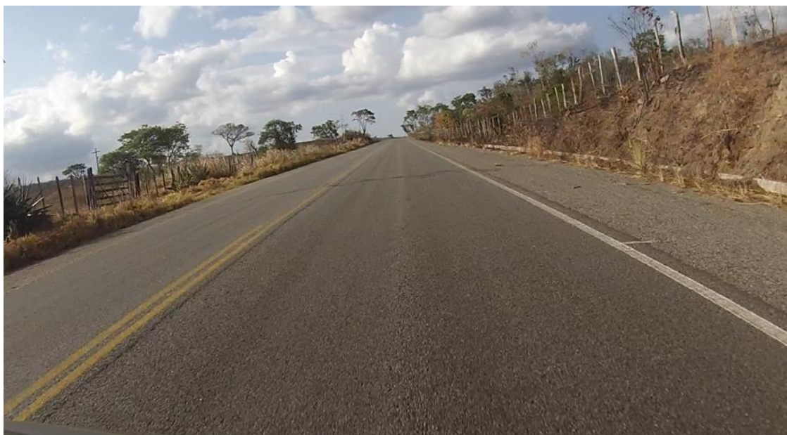
Figura 20 - km 186+000 ao km 189+000 (Km 186+100): Trecho rural, sinalização horizontal deteriorada e ausência de sinalização vertical.
