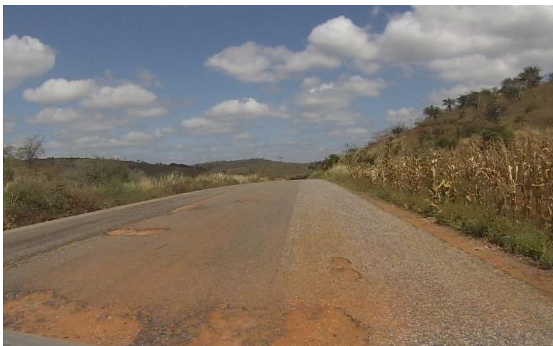
Figura 13 - km 139+600 ao km 158+000 (km 150+300): Sinalização horizontal deteriorada (faixas descascando com muitas "panelas" no bordo da pista e na faixa amarela); sinalização vertical praticamente inexistente.
