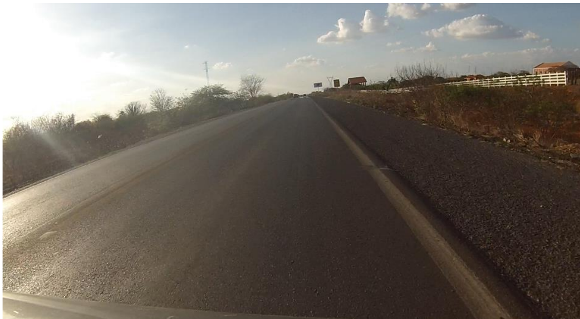
Figura 30 - km 348+000 ao km 350+000 (km 349+600): Sinalização horizontal com pintura desgastada.
