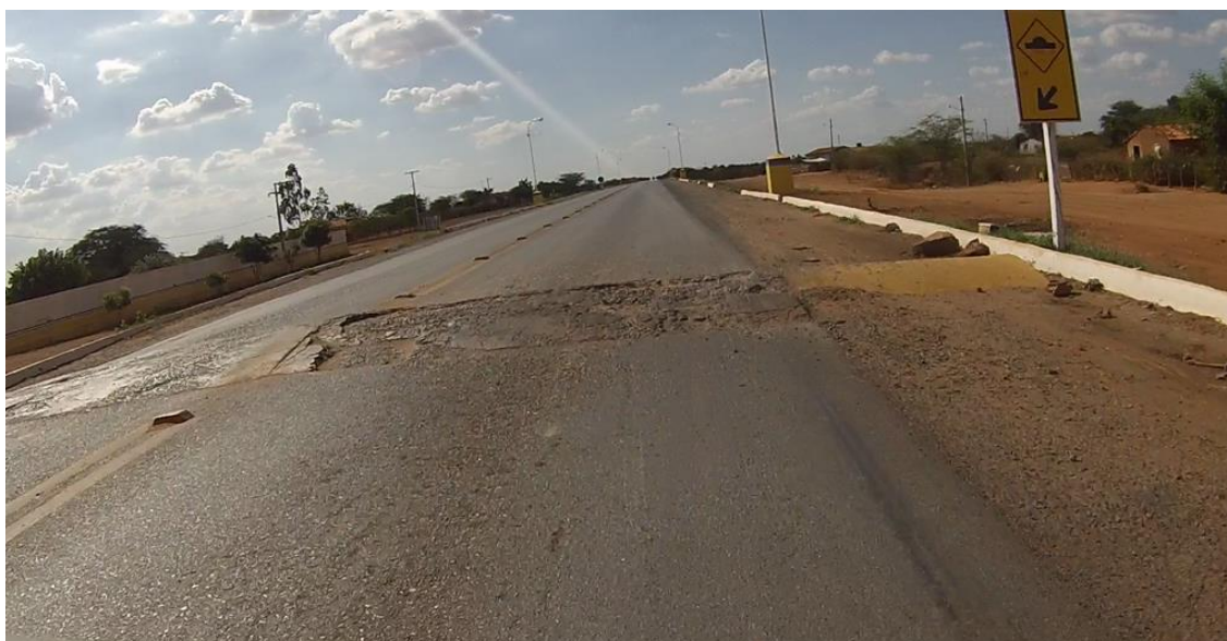
Figura 29 - km 315+500 ao km 348+000 (km 315+800): Trecho urbano - sinalização horizontal com pintura desgastada e lombada deteriorada.
