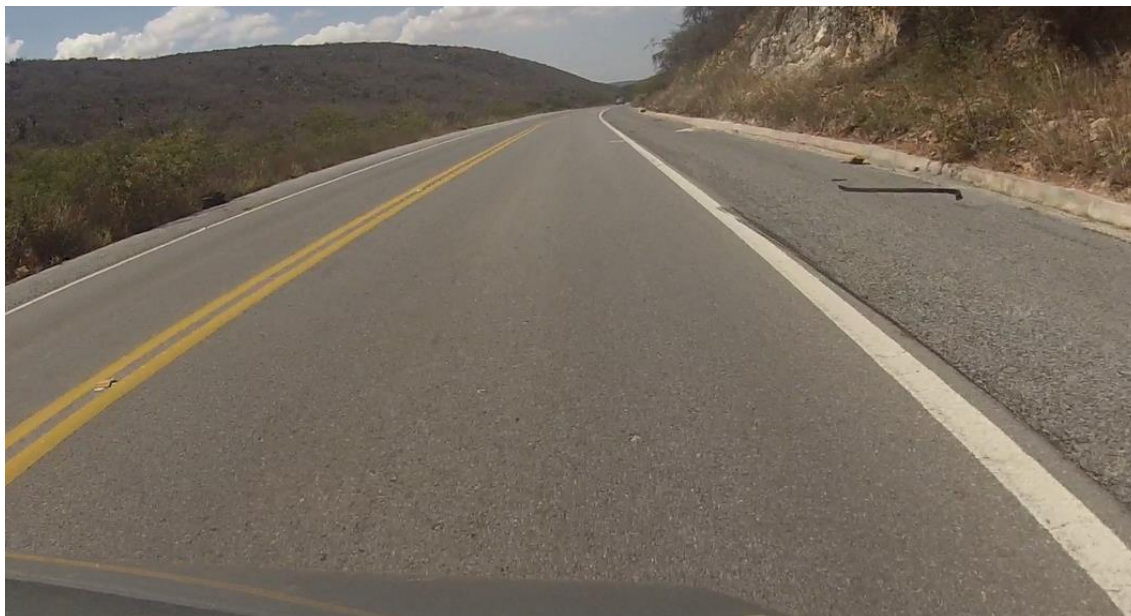
Figura 26 - km 280+000 ao km 285+000 (km 284+600): Trecho rural - sinalização horizontal visível, ausência de sinalização vertical e sujeira na pista.
