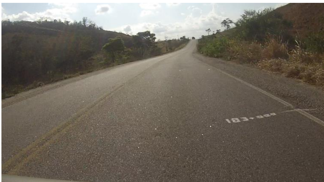
Figura 19 - km 180+000 ao km 186+000 (km 183+000): Sinalização horizontal deteriorada e sinalização vertical insuficiente.
