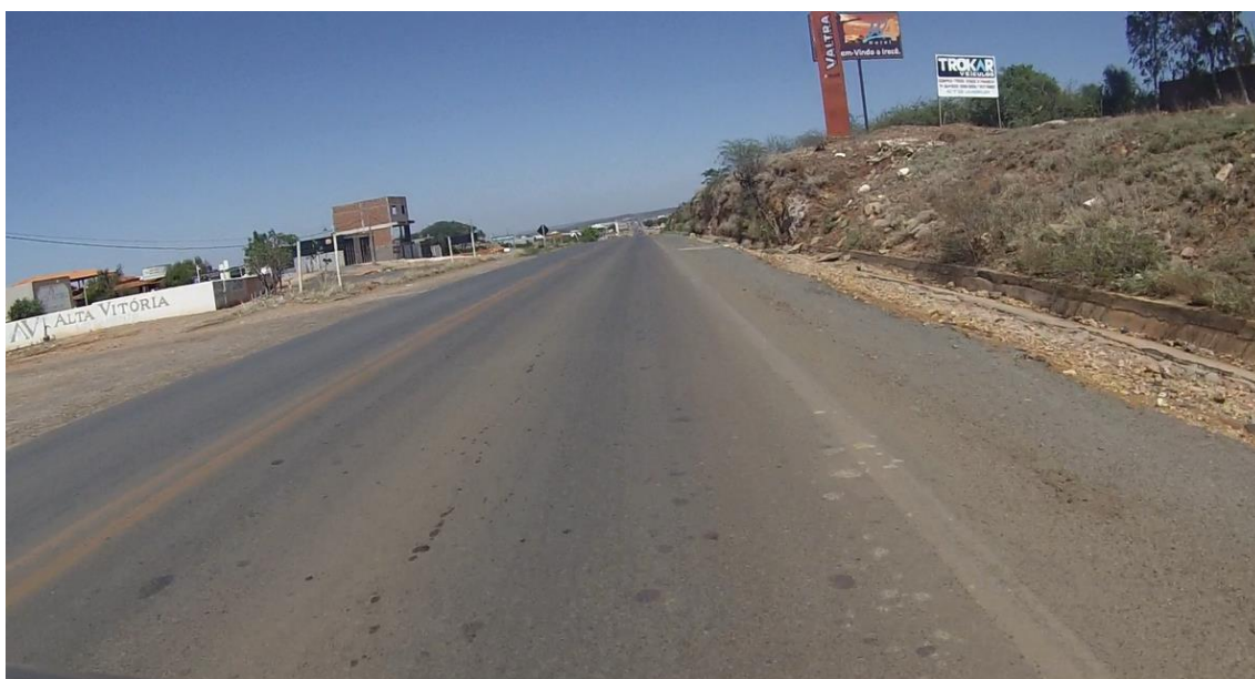
Figura 31 - km 350+800 ao km 351+000: Trecho urbano – sinalização horizontal com pintura quase inexistente.
