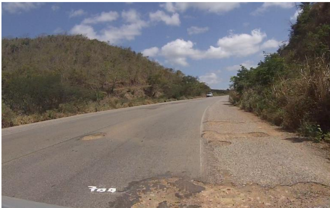
Figura 15 - km 163+500 ao km 168+000 (km 164+700): Sinalização horizontal deteriorada (faixas descascando com muitas "placas" no bordo da pista e na faixa amarela); sinalização vertical praticamente inexistente.
