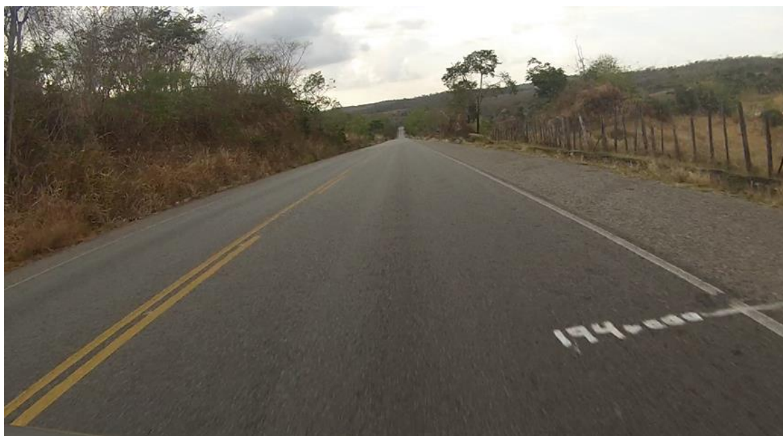
Figura 21 - km 192+00 ao km 195+000 (km 194+000): Trecho rural, sinalização horizontal deteriorada e ausência de sinalização vertical.
