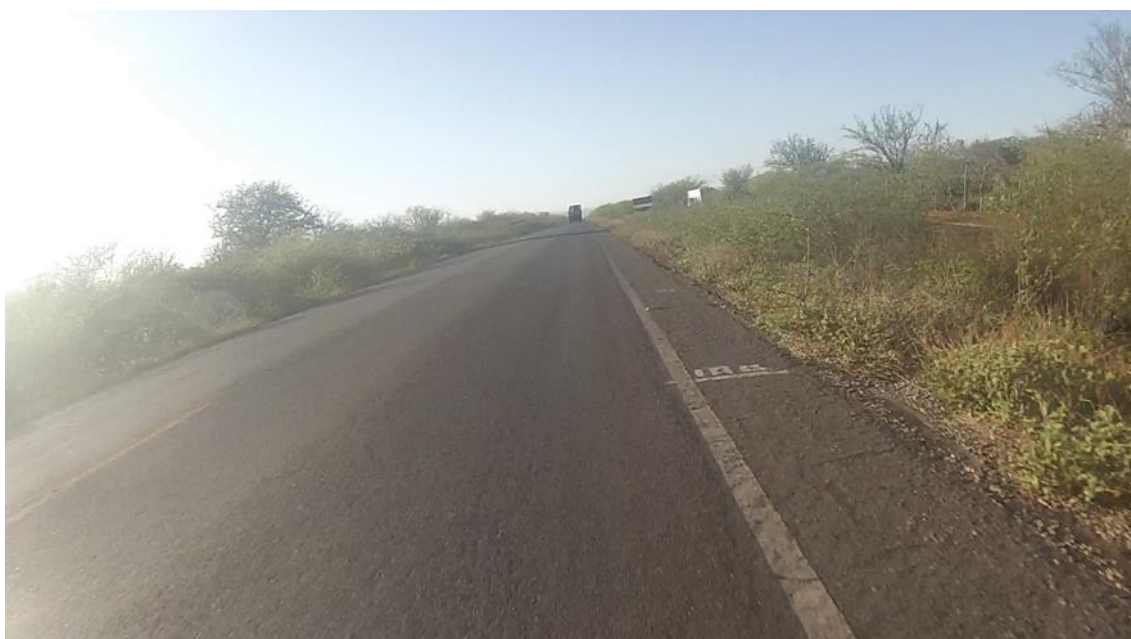
Figura 41 - km 37+500 ao 60+000 (km 45+100): Trecho rural, sinalização horizontal visível, porém, desgastada.
