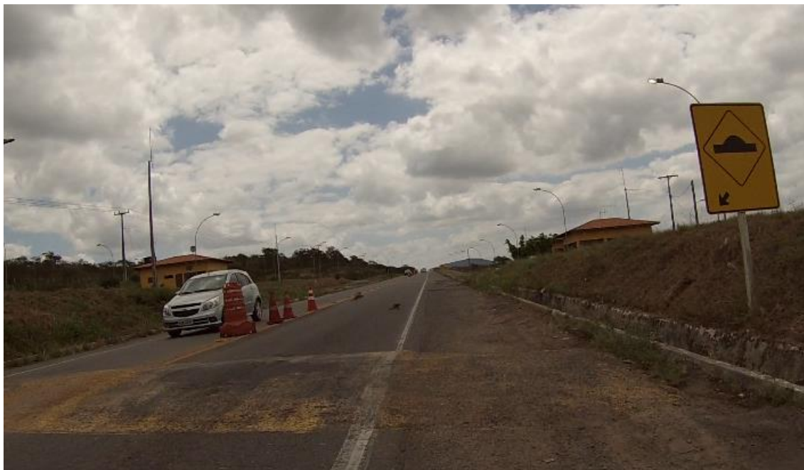
Figura 5 – km 16+500 ao Km 17+000 (km 16+500): Sinalização apagada, próximo à base da polícia rodoviária.
