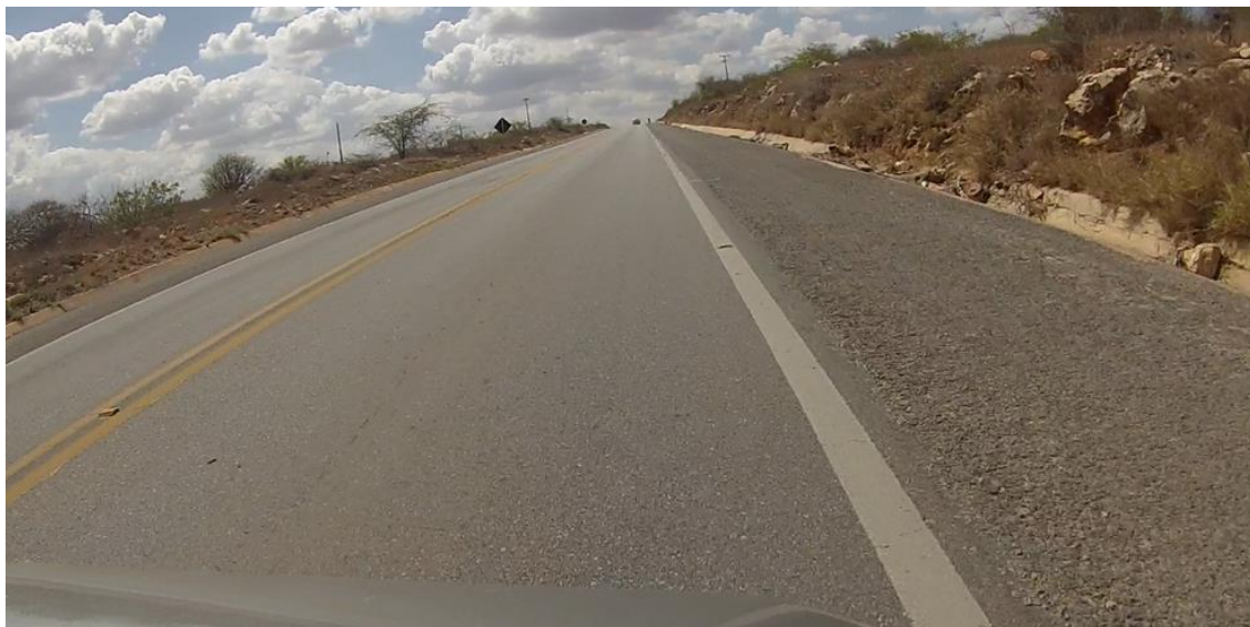
Figura 28 - km 300+000 ao km 302+000 (km 301+800): Trecho rural- sinalização horizontal com pintura desgastada.
