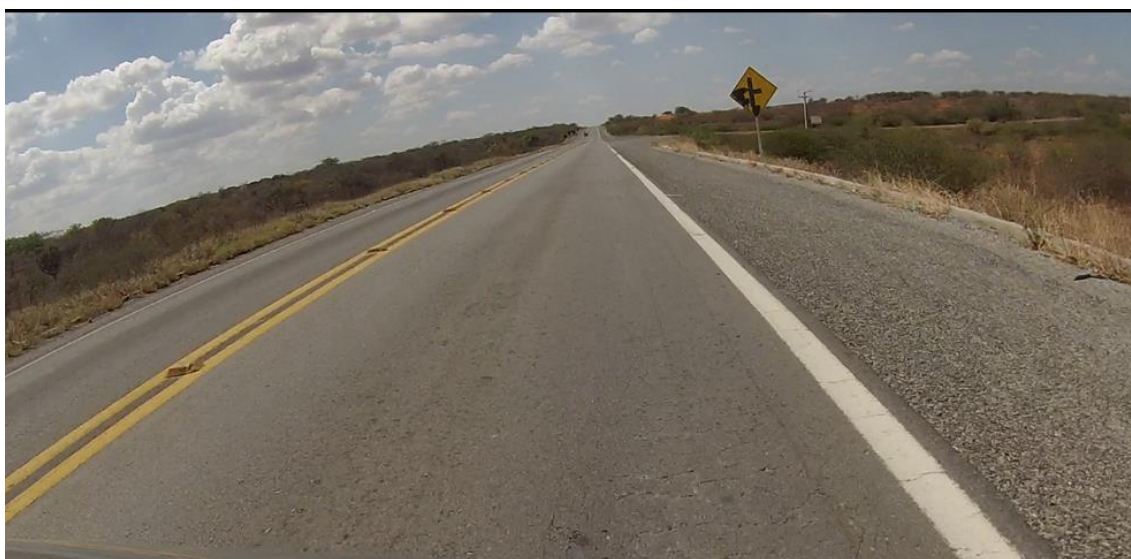
Figura 27 - km 298+000 ao km 299+000 (km 298+500): Trecho rural - sinalização horizontal visível e sinalização vertical deteriorada.
