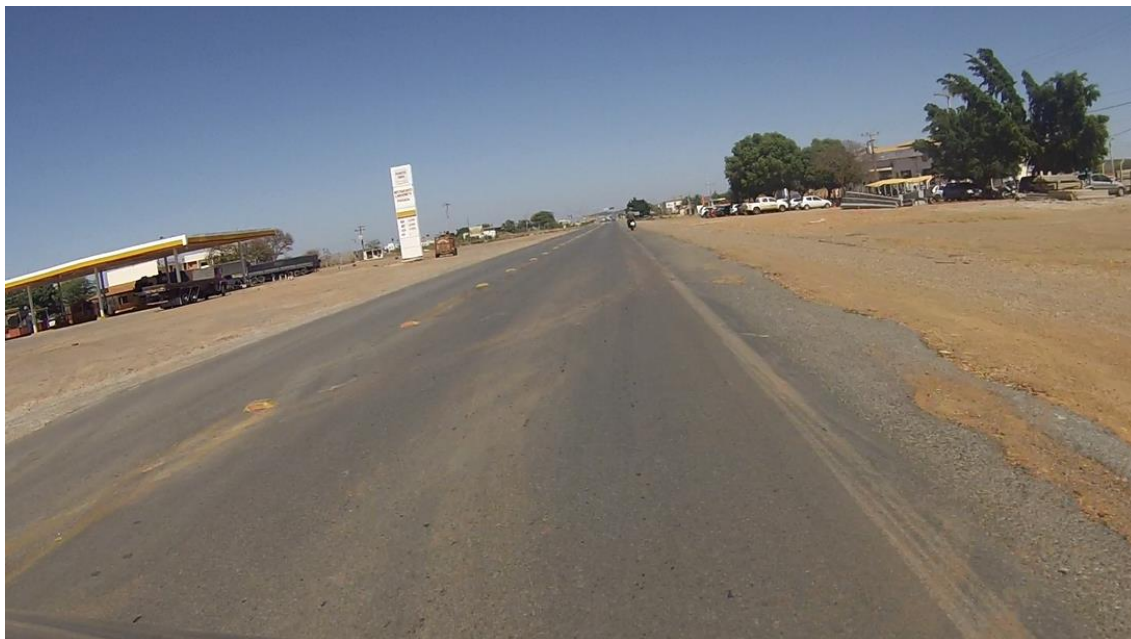
Figura 32 - km 351+200 ao km 352+200: Trecho urbano – sinalização horizontal com pintura quase inexistente.
