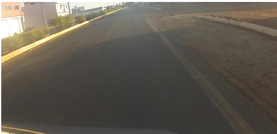
Figura 49 - km 108+000 ao 112+000 (km 108+200): Trecho urbano, pintura da sinalização horizontal quase inexistente.
