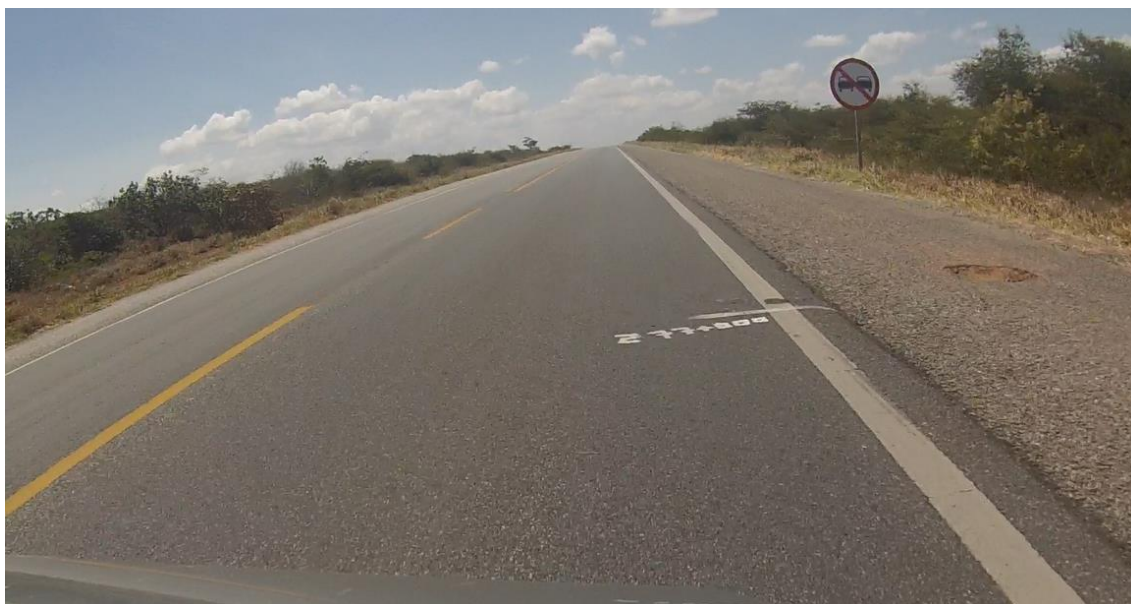
Figura 25 - km 275+000 ao km 280+000 (Km 277+000): Trecho rural, sinalização horizontal visível e buracos na pista.
