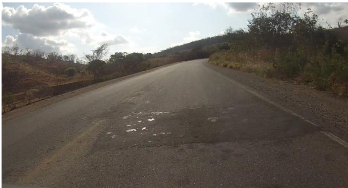
Figura 18 - km 174+900 ao km 180+000 (km 179+080): Sinalização horizontal deteriorada e sinalização vertical insuficiente.
