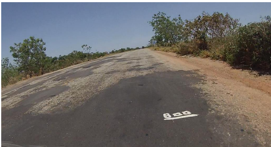
Figura 23 - km 212+700 ao km 215+200 (Km 214+800): Trecho rural, sinalização horizontal inexistente, buracos na pista.
