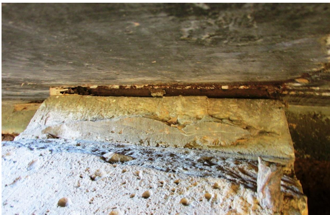
Figura 150 - Vista do aparelho de apoio esmagado. Notar também disgregação do concreto junto à almofada de base.
