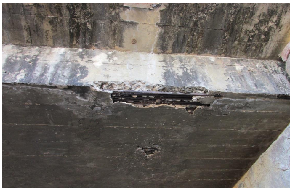
Figura 38 - Visão de concreto disgregado com armadura exposta e oxidada na extremidade do tabuleiro da obra.
