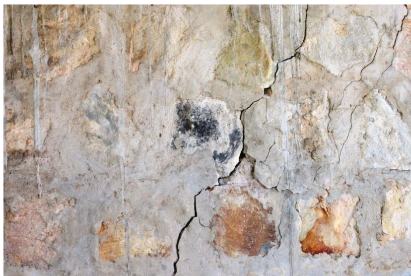
Figura 2 – Trinca nas paredes dos apoios da OAE N°25 - km 48+300 - BA-160
