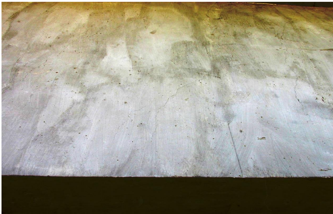
Figura 138 - Vista de fissuras junto à face lateral da viga longitudinal.
