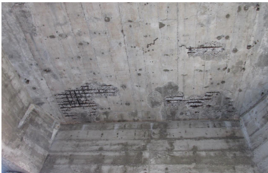
Figura 34 - Detalhe de disgregação do concreto com armaduras expostas e oxidadas, junto a superfície do tabuleiro.
