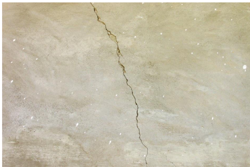
Figura 4 – Fissura de abertura superior a 0,3 mm - OAE N°33 - km 79+800 - BA-160
