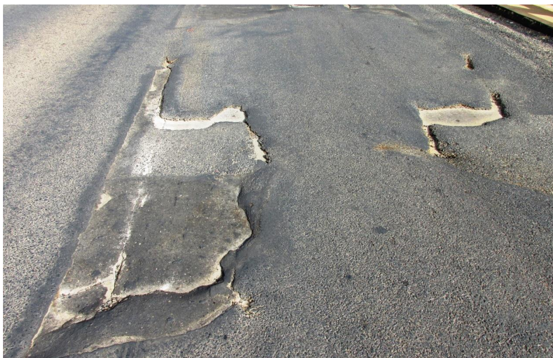
Figura 90 - Notar pista de rodagem com deterioração do pavimento e formação de painelas.
