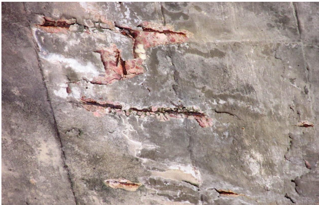
Figura 66 - Trecho com disgregação superficial do concreto, com armaduras expostas e oxidadas na face inferior da laje lateral em balanço.
