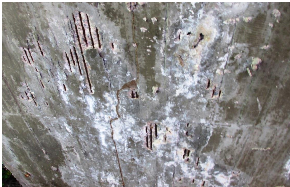
Figura 14 - Detalhe de armaduras expostas e oxidadas junto à laje tipo caixa.
