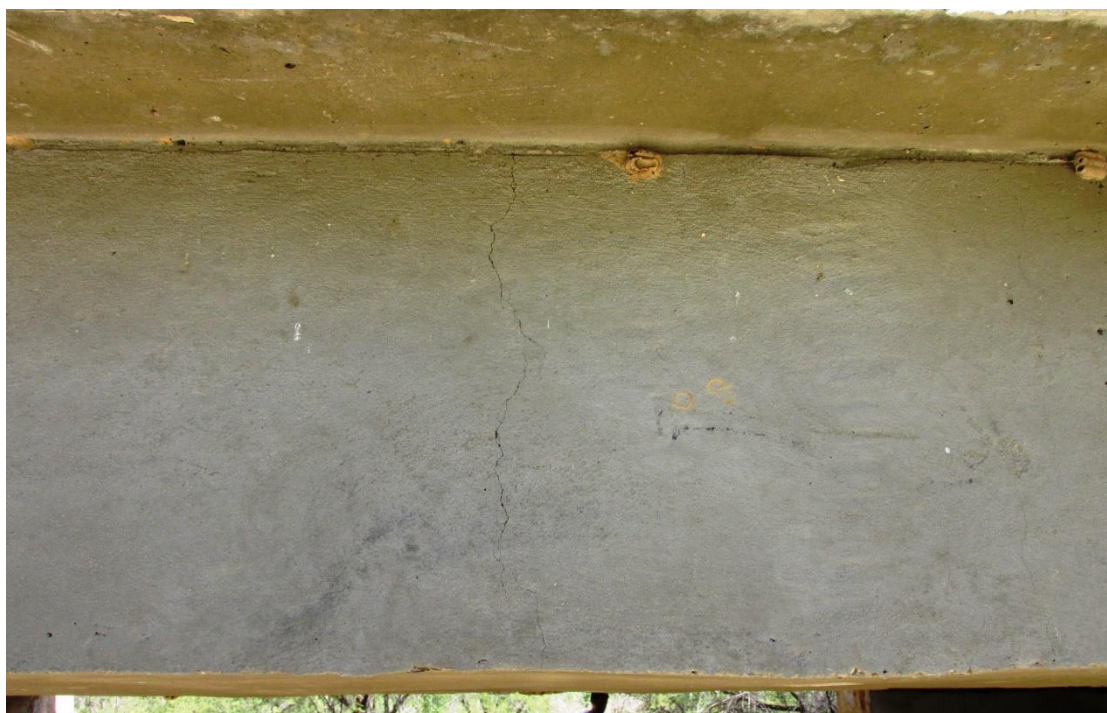
Figura 122 - Visão aproximada de fissura na face lateral da viga longarina.
