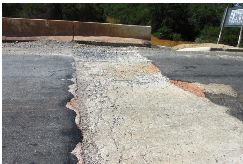
Figura 7 – OAE com ruptura nos encontros - OAE N°292 - km 70+800 - BA-160
