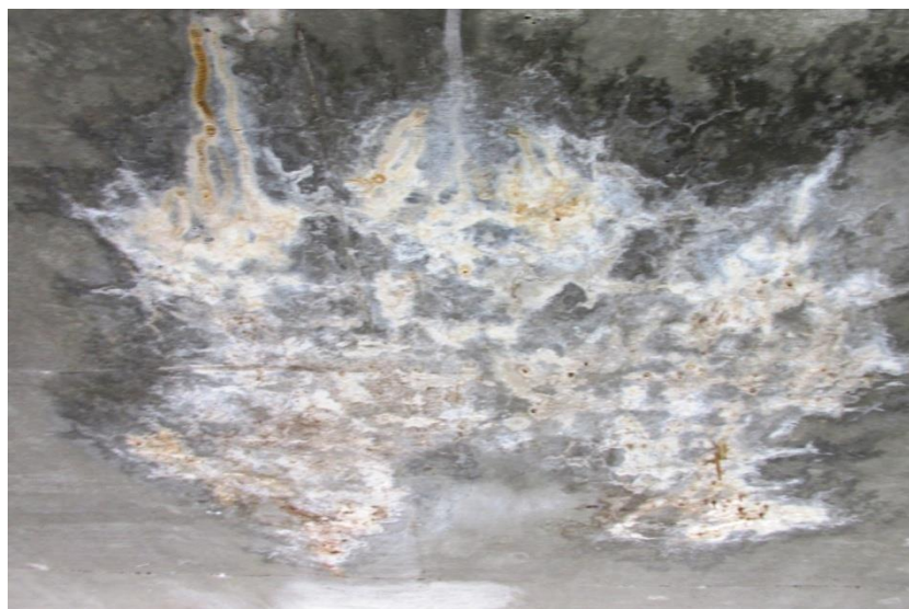
Figura 10 – Eflorescência - OAE N°22 - km 34+900 - BA-160
