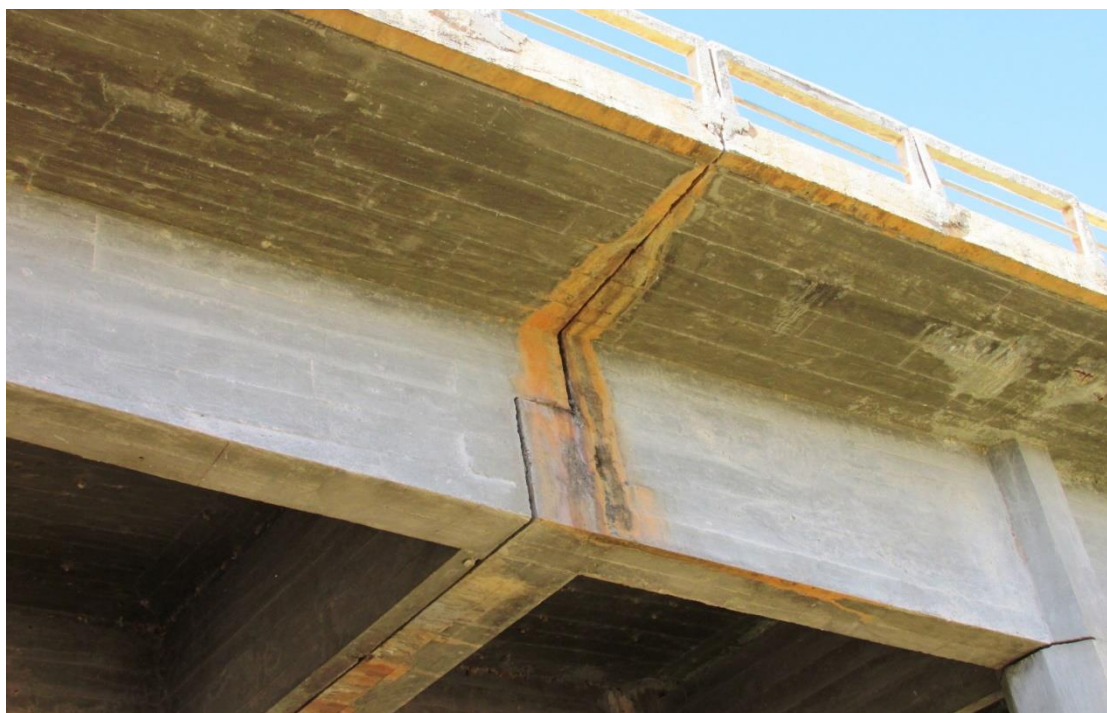
Figura 86 - Vista de mancha de escurimento na laje lateral em balanço, bem como na viga longitudinal, junto ao dente Gerber
