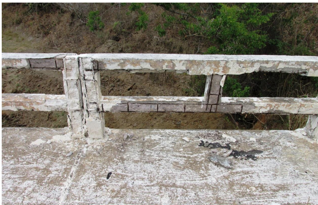
Figura 58 - Notar disgregação do concreto com armaduras expostas e oxidadas por toda a estrutura do guarda-corpo, na lateral da pista de rodagem.
