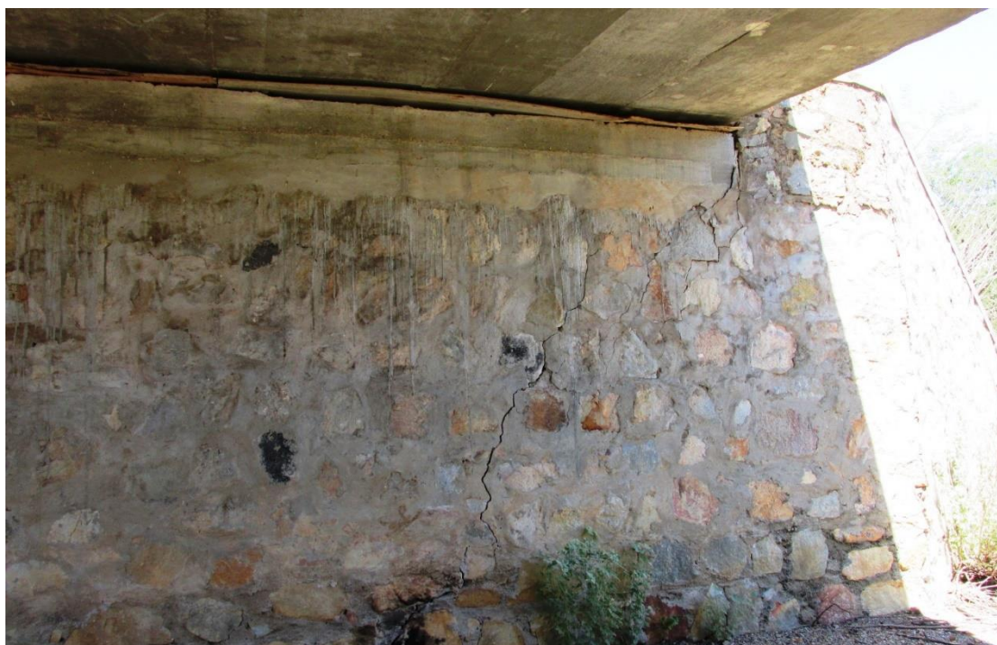
Figura 110 - Vista de trinca junto a estrutura de apoio, bem como restos de formas no encontro da superestrutura com a mesma.
