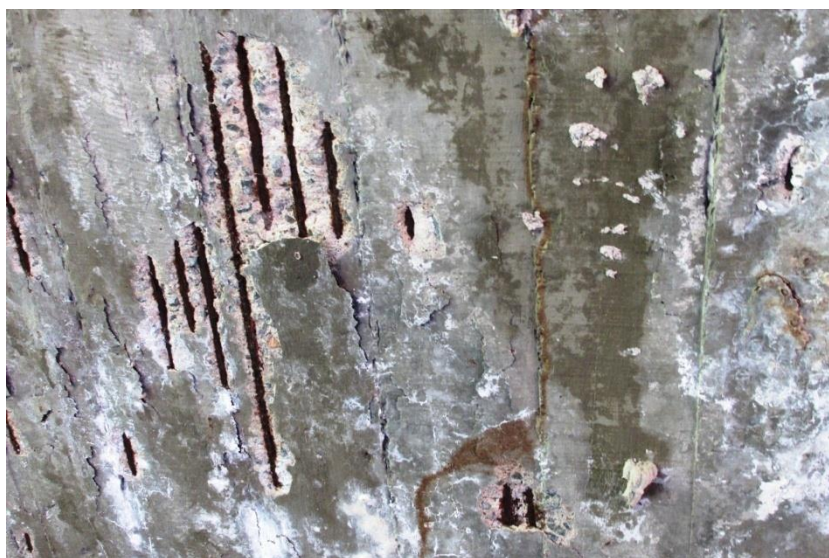
Figura 8 – Armaduras expostas e corroídas - OAE Nº01 - km 34+100 - BA-052
