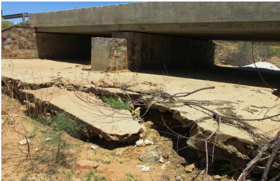
Figura 94 - Enfoque em base rompida de piso sob a ponte, com formação de erosão.
