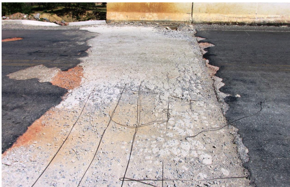
Figura 126 - Visão do pavimento deteriorado junto da cabeceira de encontro da ponte.
