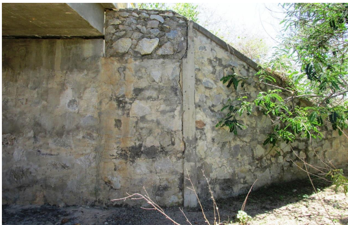
Figura 118 - Vista de trinca junto ao muro de ala lateral a obra.
