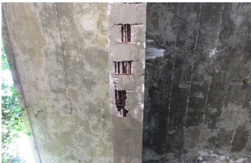
Figura 18 - Vista de trechos com disgregação do concreto, bem como armaduras expostas e oxidadas na face inferior da viga longitudinal.
