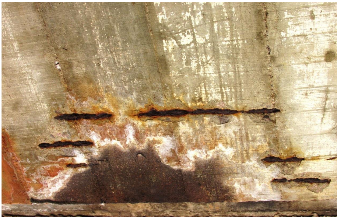
Figura 78 - Trecho com armaduras expostas e oxidadas, bem como mancha de escorrimento junto à extremidade do tabuleiro.
