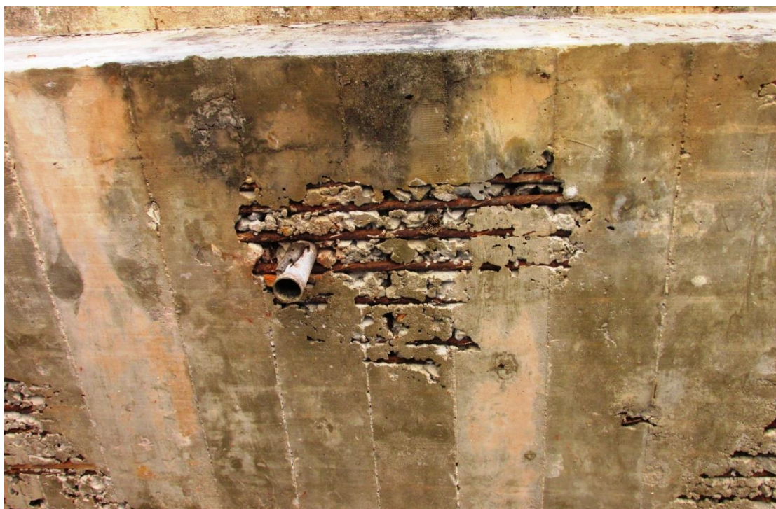
Figura 82 - Vista de pontos com segregação do concreto, bem como armaduras expostas e oxidadas na superfície do tabuleiro.
