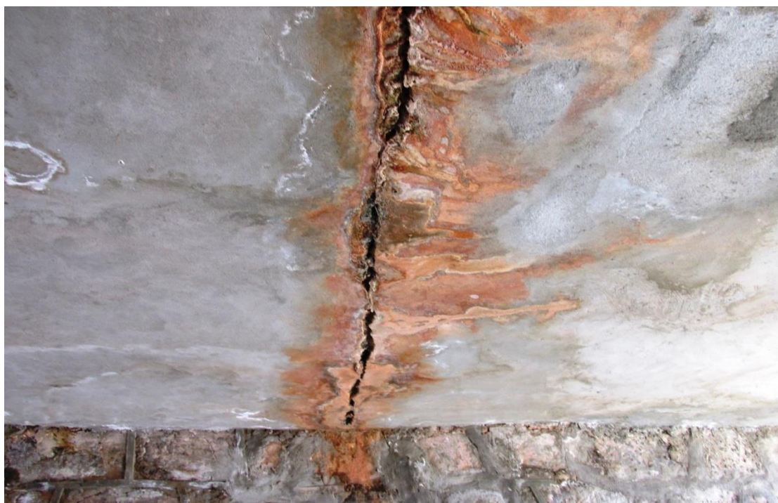
Figura 70 - Visão aproximada de trinca na superfície do tabuleiro da obra.
