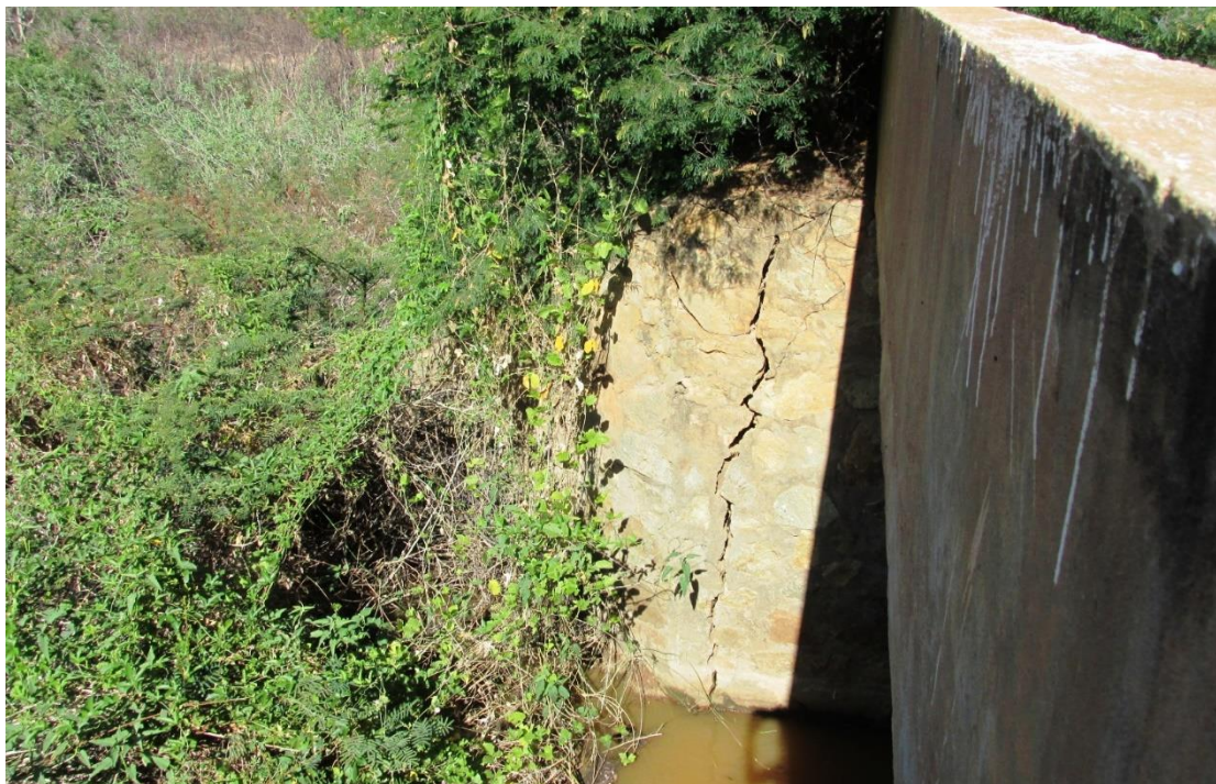
Figura 146 - Vista do rompimento do muro de ala lateral a obra.
