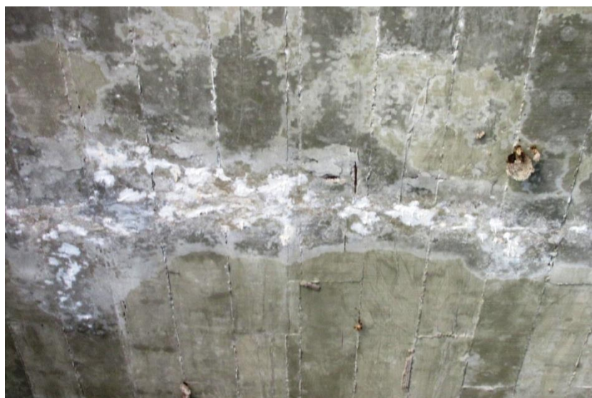
Figura 9 – Eflorescência - OAE N°02 - km 43+600 - BA-052
