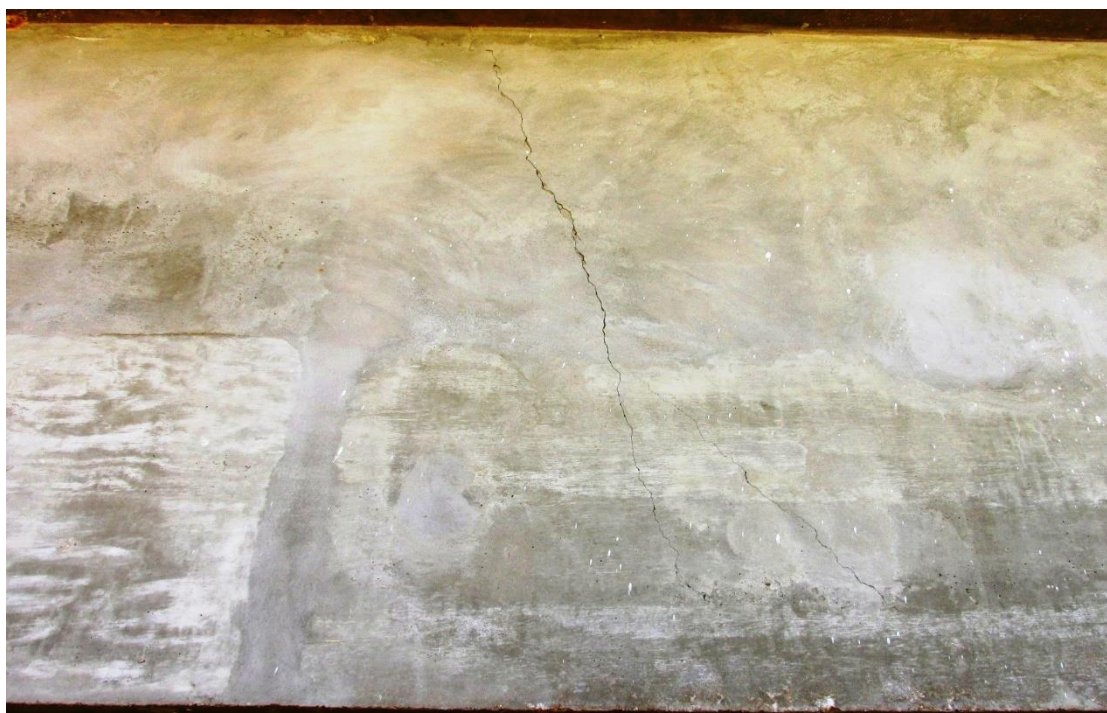
Figura 142 - Vista de fissuras na superfície da viga longarina.
