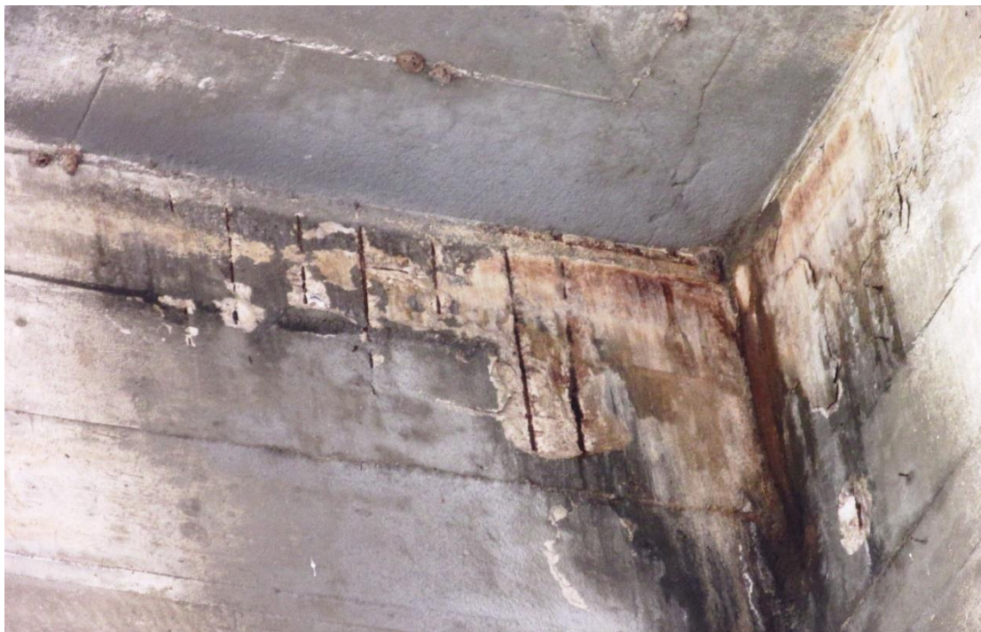
Figura 50 - Vista de concreto disgregado com armaduras expostas e oxidadas na face lateral da viga longitudinal, bem como na viga transversina.
