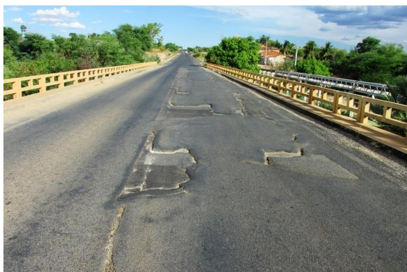
Figura 6 – Exemplos de deformações intensas do pavimento (OAEs 04 e 20)
