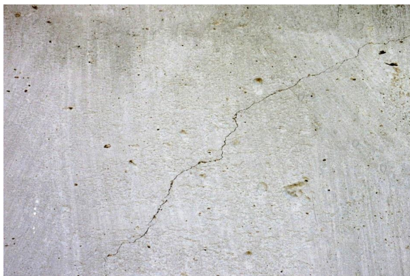
Figura 3 – Fissura indicativa de flexão acentuada nas longarinas - OAE N°32 - km 78+500 - BA-160
