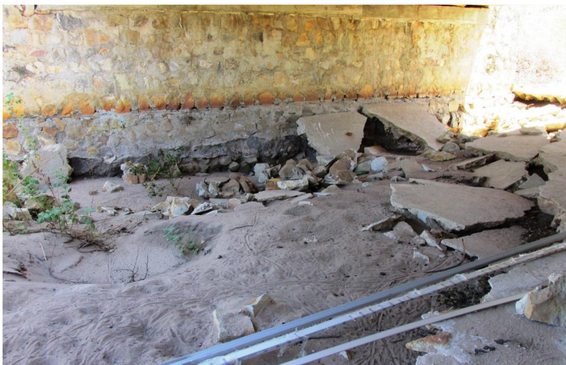
Figura 102 - Notar erosão sob a obra, com ruptura da estrutura do piso.
