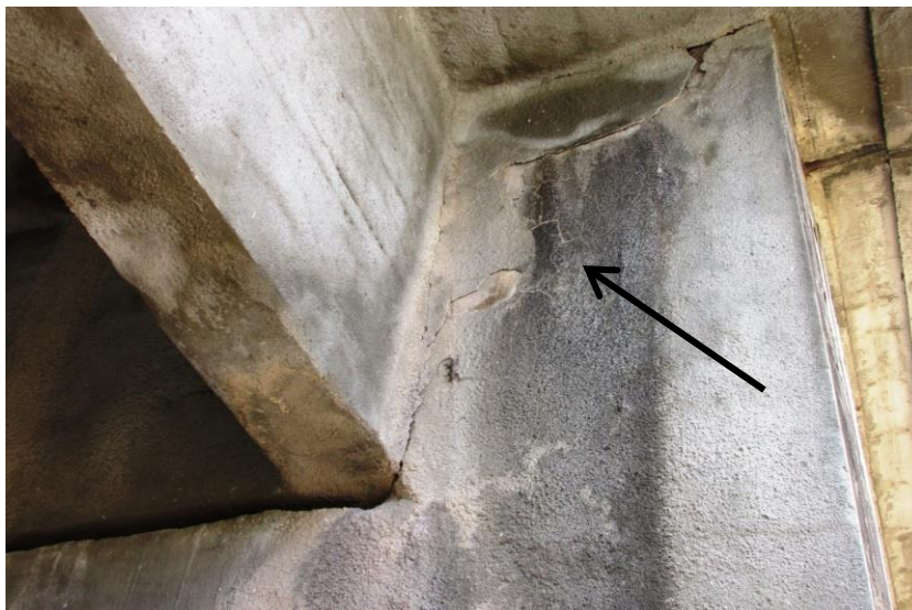
Figura 1 – Trinca de Deslocamento da OAE N°10 - km 103+300 - BA-052
